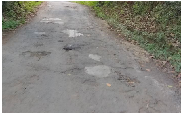
Gambar 2. Jalanan Rusak (Sumber : KKN Kelompok 25).
